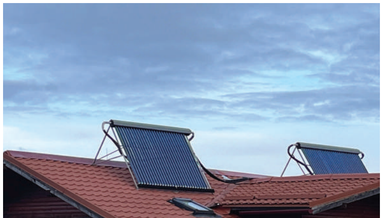
Fig. 5.2. Panouri solare termice
